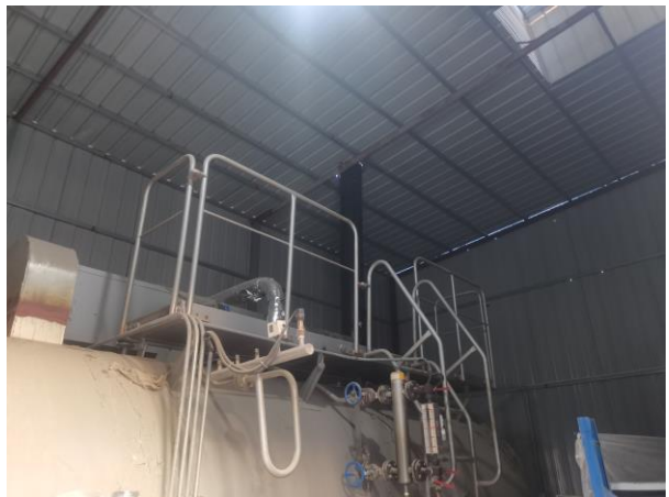
天然气锅炉排气筒
