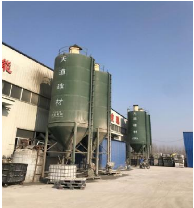
筒仓仓顶除尘器
