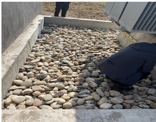
风机机组变压器放置于围堰内
