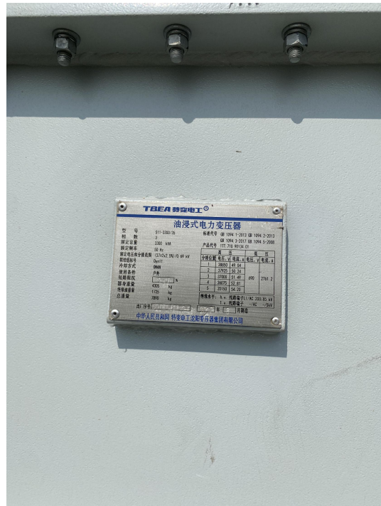
风机机组变压器铭牌
