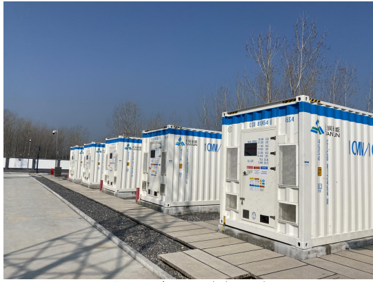
升压站变压器密闭隔声
