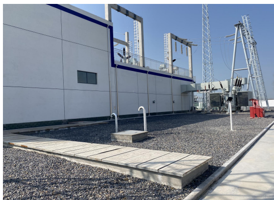
升压站事故油池
