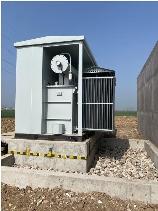
风机机组变压器
