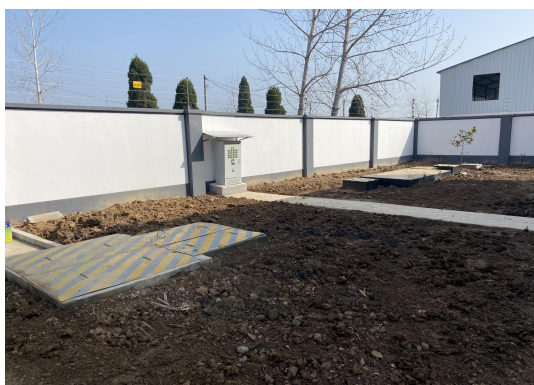
地埋式污水处理设施
