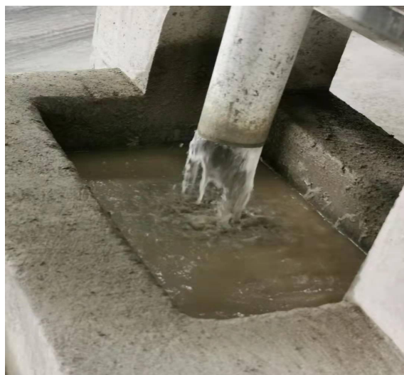
设备清洗废水收集沟
