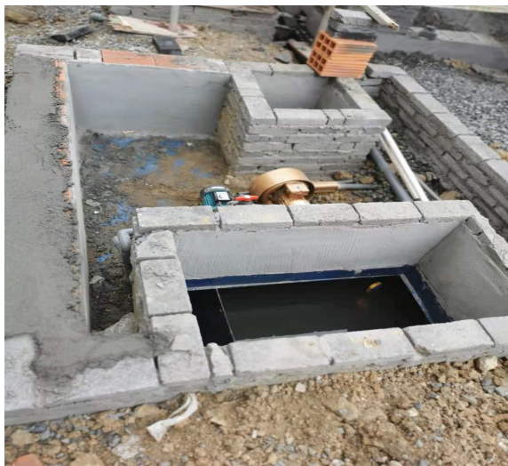
生活污水装置
