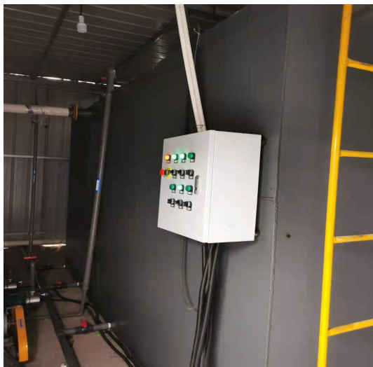
生活污水处理装置
