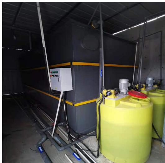
雨水处理装置
