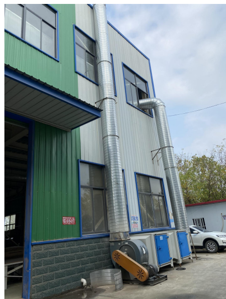
面漆房二级活性炭吸附装置
