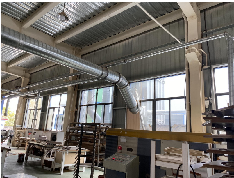
废气收集管线
