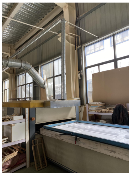
一层冷压工序集气设施
