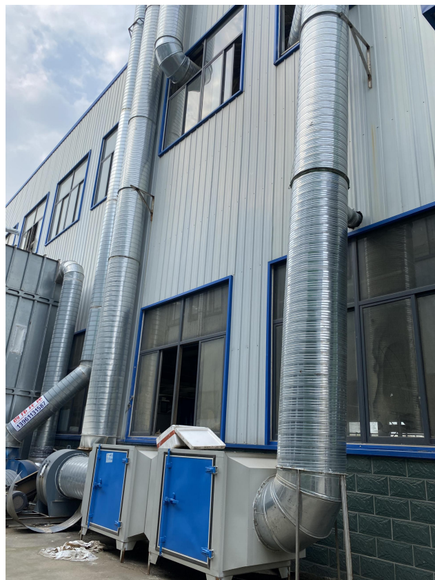
底漆房有机废气二级活性炭吸附装置
