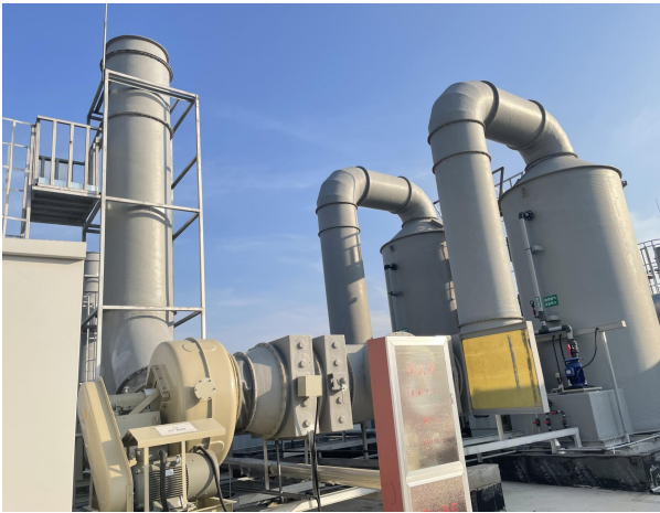
B 厂酸性废气洗涤塔+排气筒 (DA004)
