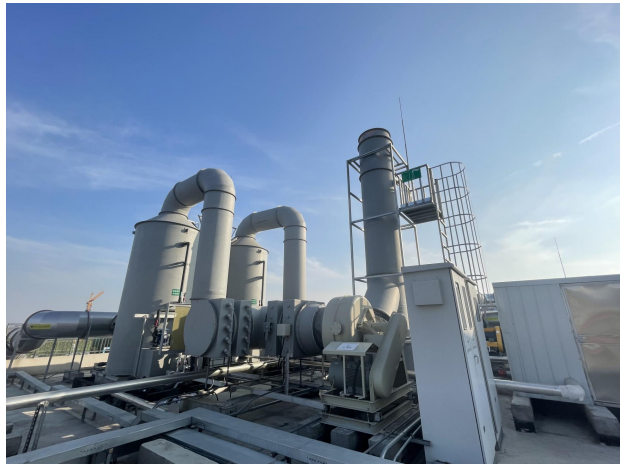
A 厂酸性废气洗涤塔+排气筒 (DA002)
