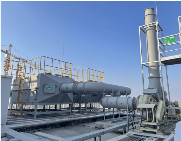
除臭吸附塔+排气筒 (DA006)
