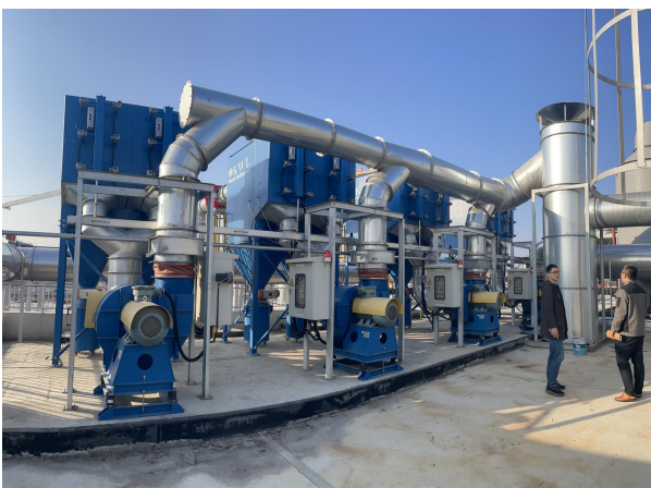
熔射除尘器+排气筒 (DA001)
