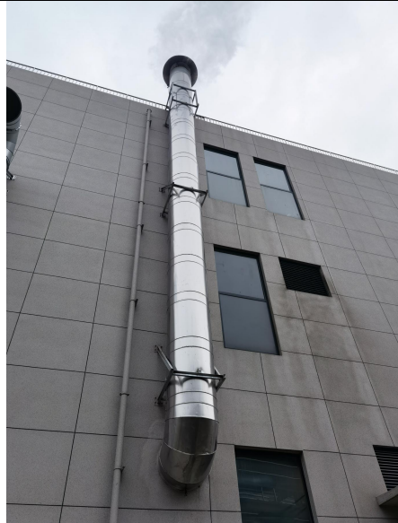
锅炉排气筒 (DA005)
