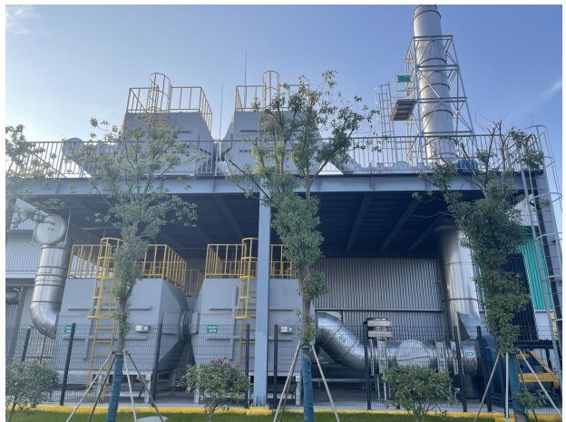
有机废气活性炭设备+排气筒 (DA003)
