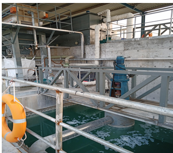
二期污水处理设施
