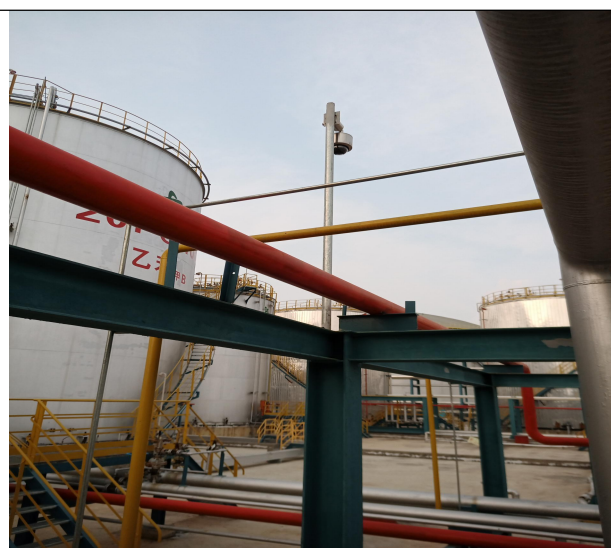
罐区气体检测仪
