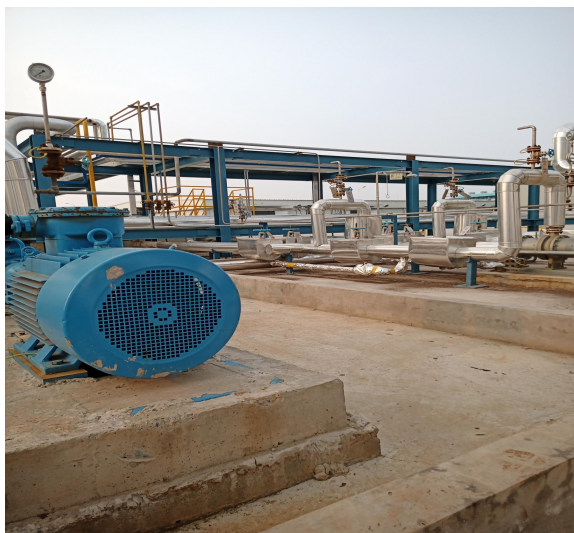
污水提升泵站
