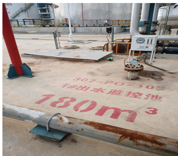
污水外排监控池
