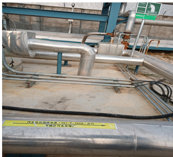
厂区污水排放管线
