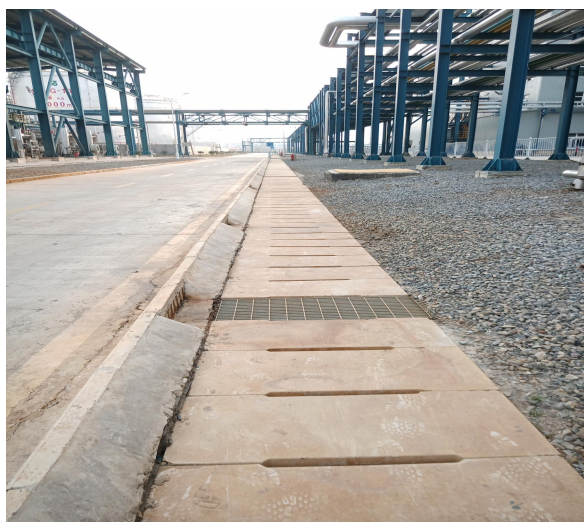
厂区雨水排放管线
