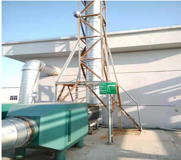
危废库废气处理设施及排气筒
