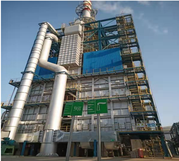
加热炉废气排气筒
