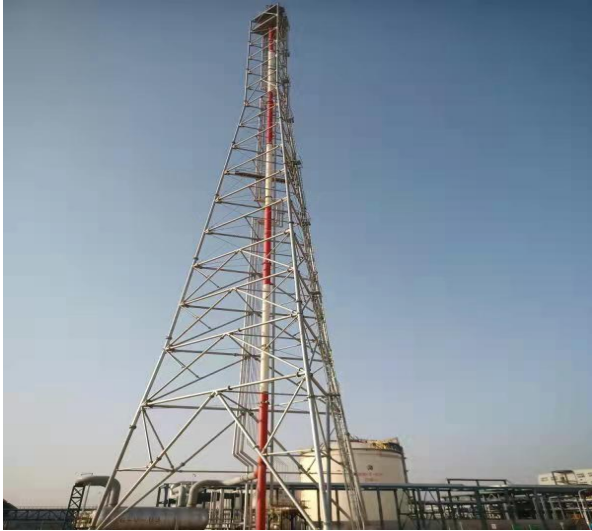
高架火炬燃烧系统
