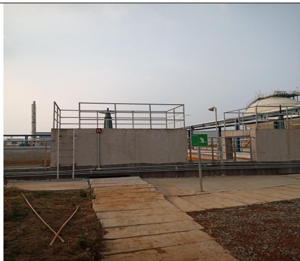
事故水切换阀
