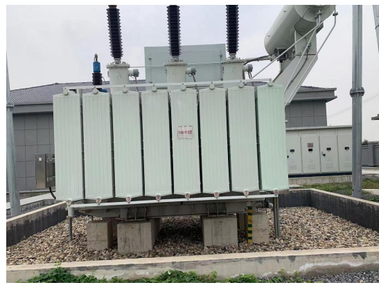
升压站主变压器减震基础
