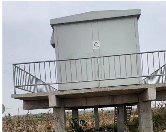
风机机组变压器密闭隔声（侧面）
