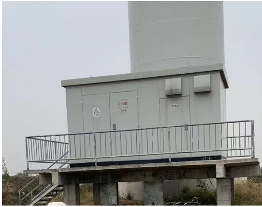
风机机组变压器密闭隔声（正面）
