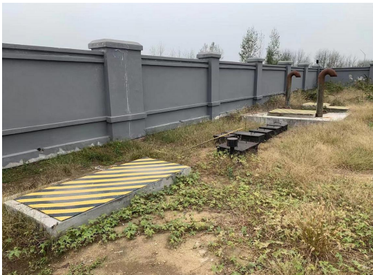
地埋式污水处理设施
