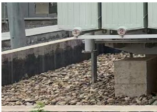
风机机组变压器放置于围堰内
