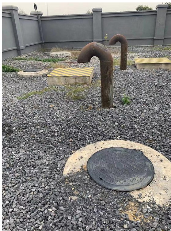
升压站事故油池
