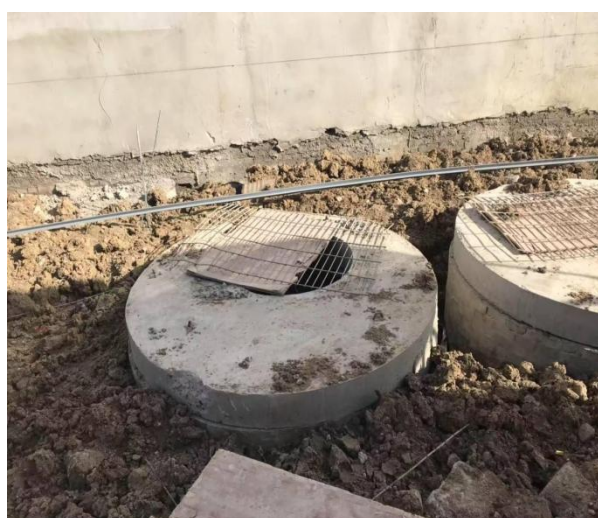
初期雨水集水井
