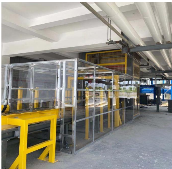
破碎间上料系统密闭措施
