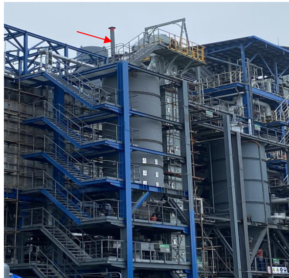
飞灰仓顶排气筒 P6
