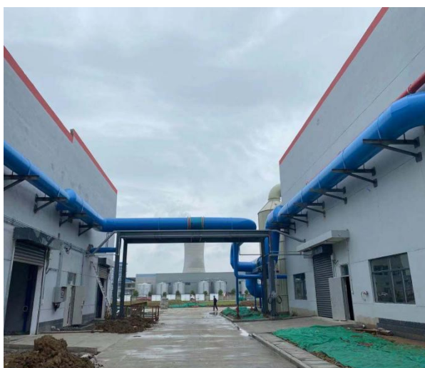
废气收集管线
