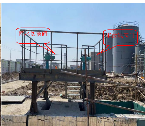
雨水排口应急切断阀
