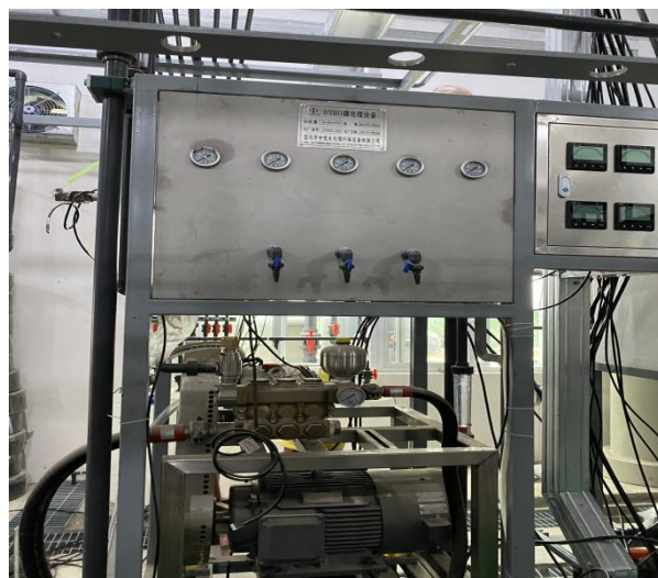
污水处理 DTRO 设备
