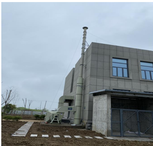
实验室废气处理装置及排气筒 P5
