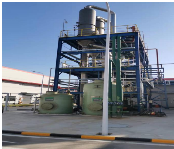
综合废水处理系统
