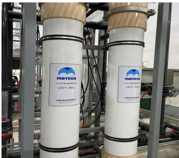
污水处理超滤组件
