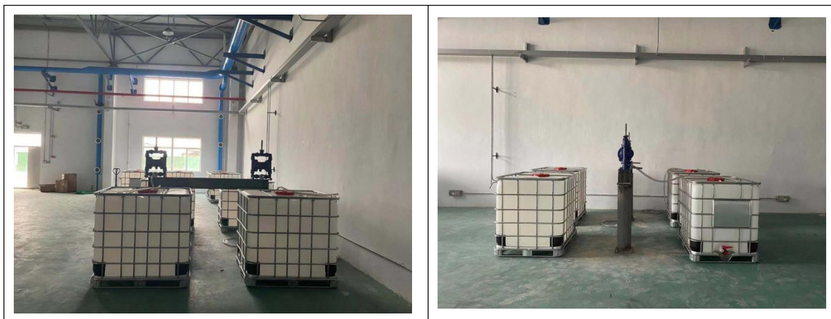
图 2.4-1 危废预处理配套吨桶及隔膜泵
