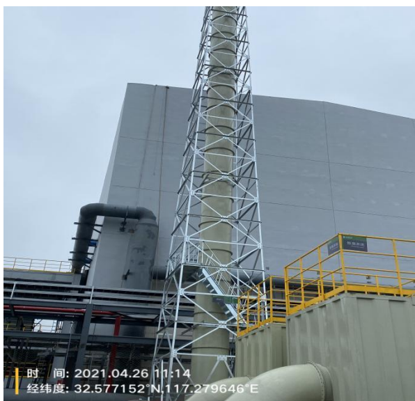
料坑、破碎间废气处理装置及排气筒 P3
