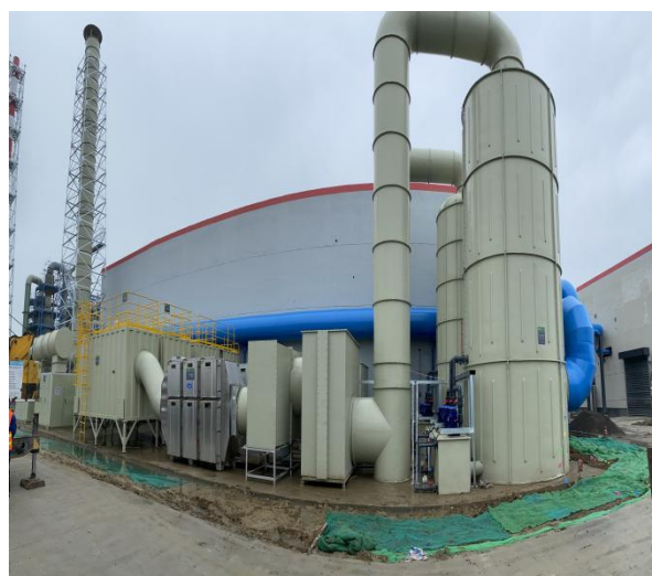
危废暂存库废气处理装置及排气筒 P2
