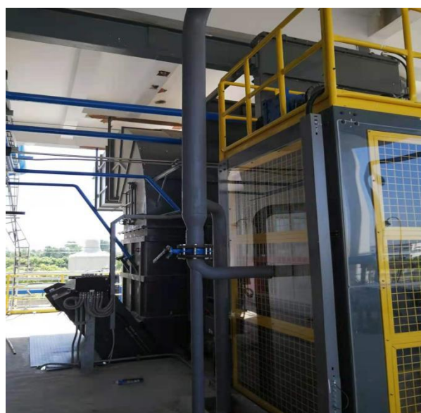
破碎间上料系统废气收集管线
