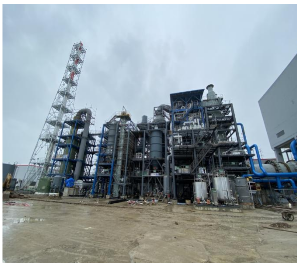
焚烧线废气处理设施及排气筒 P1
