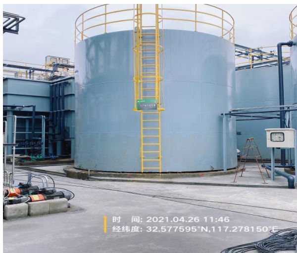
生产废水收集罐
