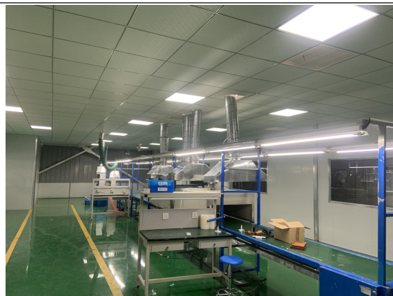
印刷工序废气收集
