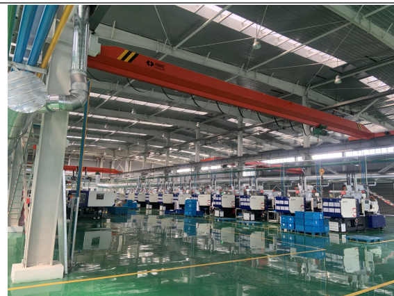
注塑工序废气收集
