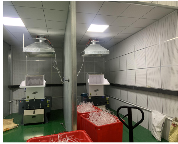
破碎工序废气收集
