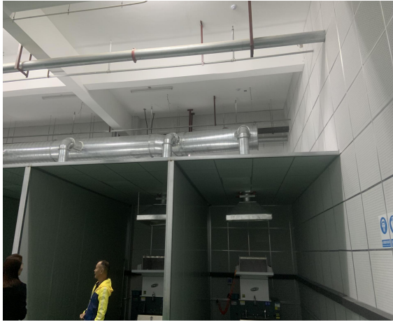
破碎工序废气收集
