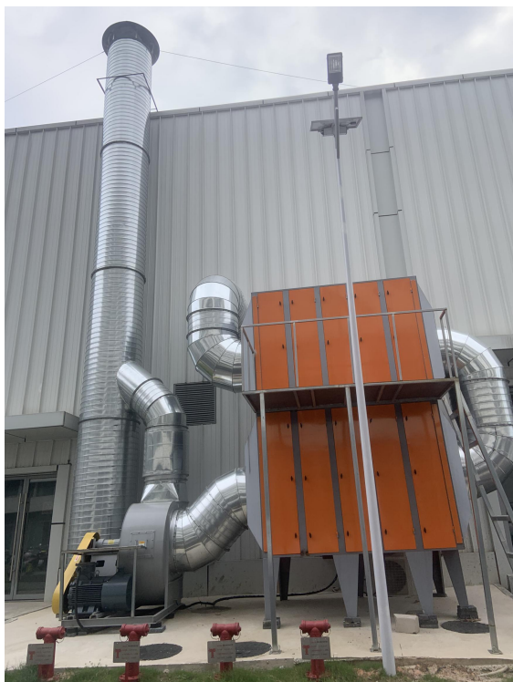
注塑、印刷工序：二级活性炭吸附装置+15m高排气筒
