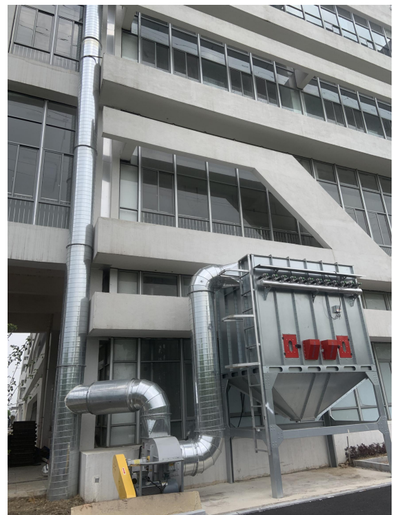
破碎工序：布袋除尘器+15m高排气筒
