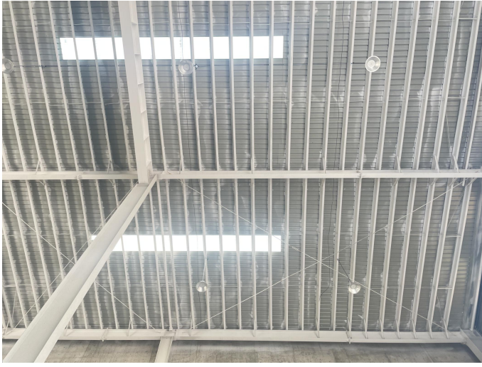
进料口上方喷淋设施
